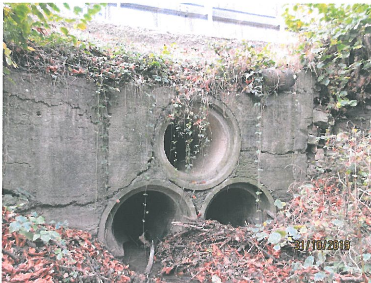
Pohled na vtokovou stranu mostu. Na vtoku je spodní jedna roura zanesena naplaveninami.
