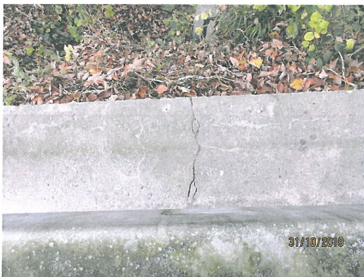
Římsa na výtokové straně prasklá uprostřed.
