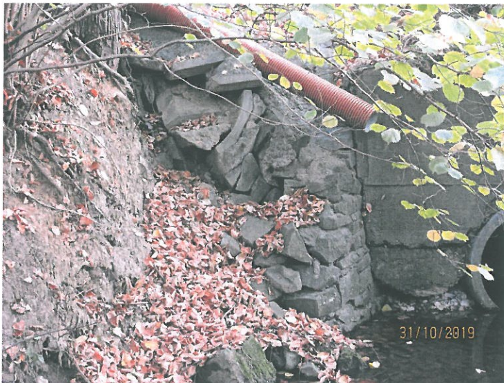
Na výtokové straně se rozpadá kamenné křídlo.
