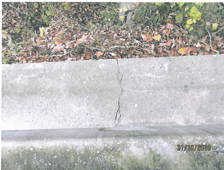
Římsa na výtokové straně prasklá uprostřed.
