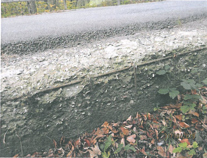
Na vtokové straně se drolí beton římsy a je obnažena armovací výztuž.
