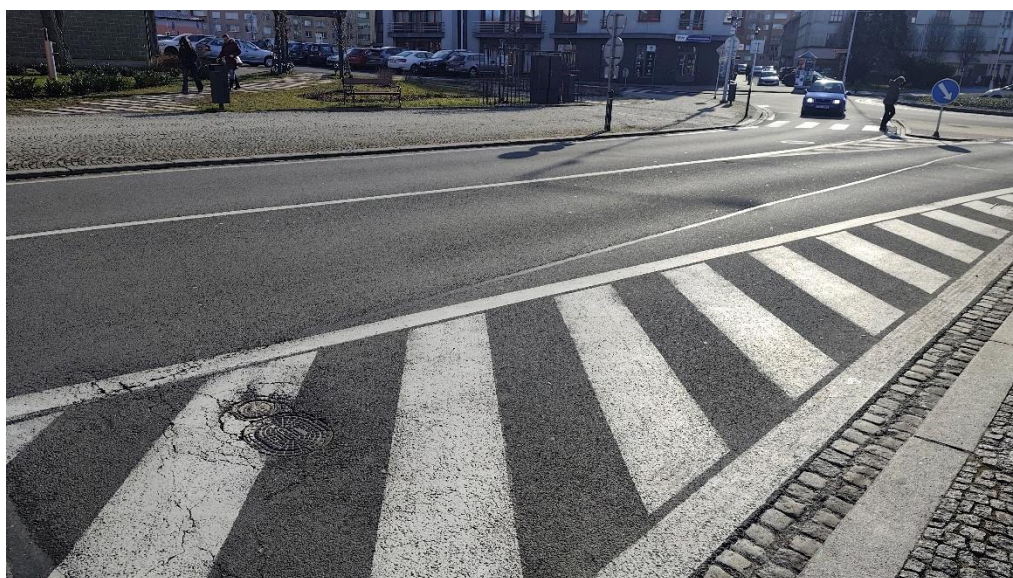
Pohled proti směru zatrubněného potoka. Vozovka je bez závad, kromě míst kolem vodovodních armatur.
