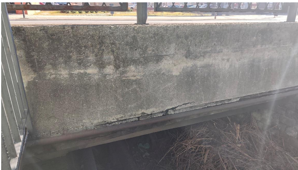
Povrch římsy je degradován, lokálně zavlhlý. Lokálně odpadává krycí vrstva omítky.
