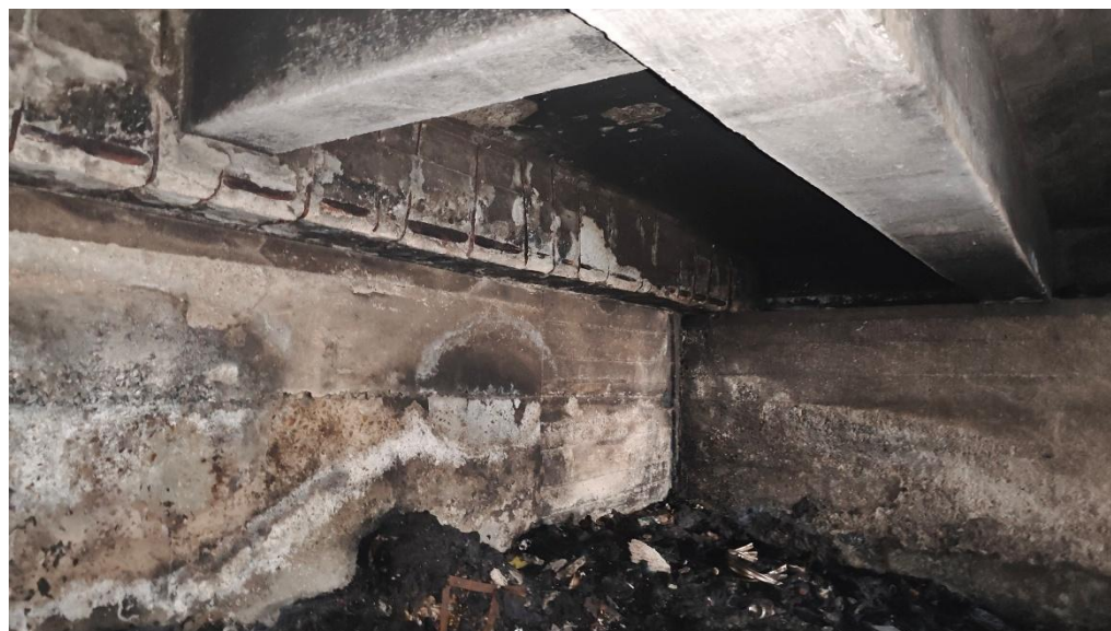
Po požáru došlo k delaminaci (odpadnutí) části podhledu. Beton podhledu je hloubkově degradován až za nosnou výztuž desky NK.
