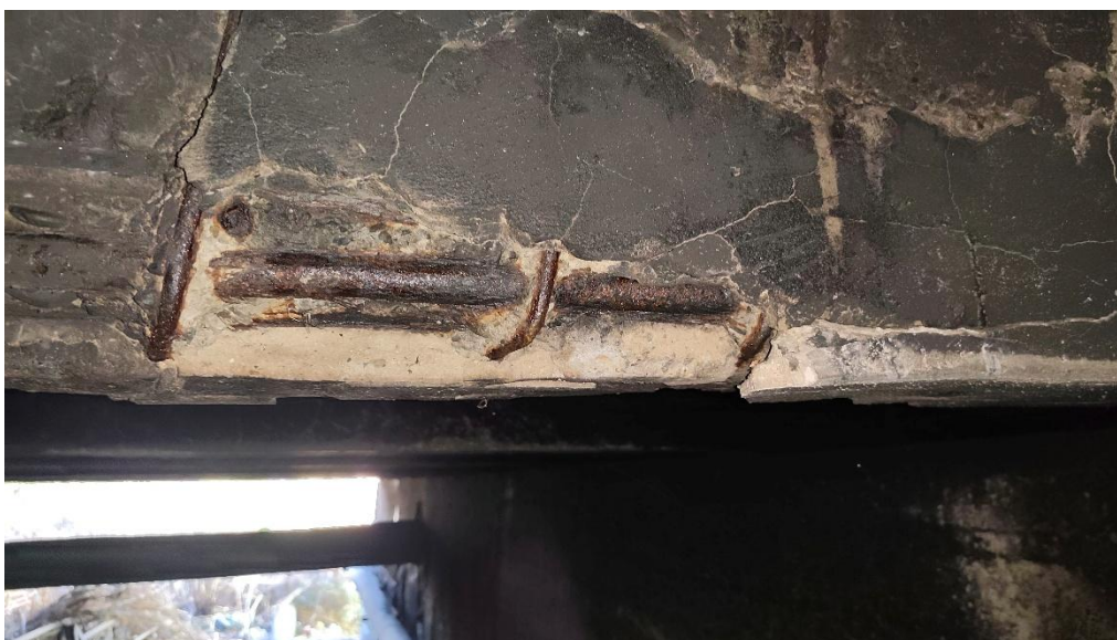
Poškozený nosník č. 11. Nosníky mají na povrchu trhliny větší jak 2 mm. Sanační hmota je silně potrhaná a odpadáva. Po požáru se stav nosníku zhoršil, zvětšil se rozsah poškození!
