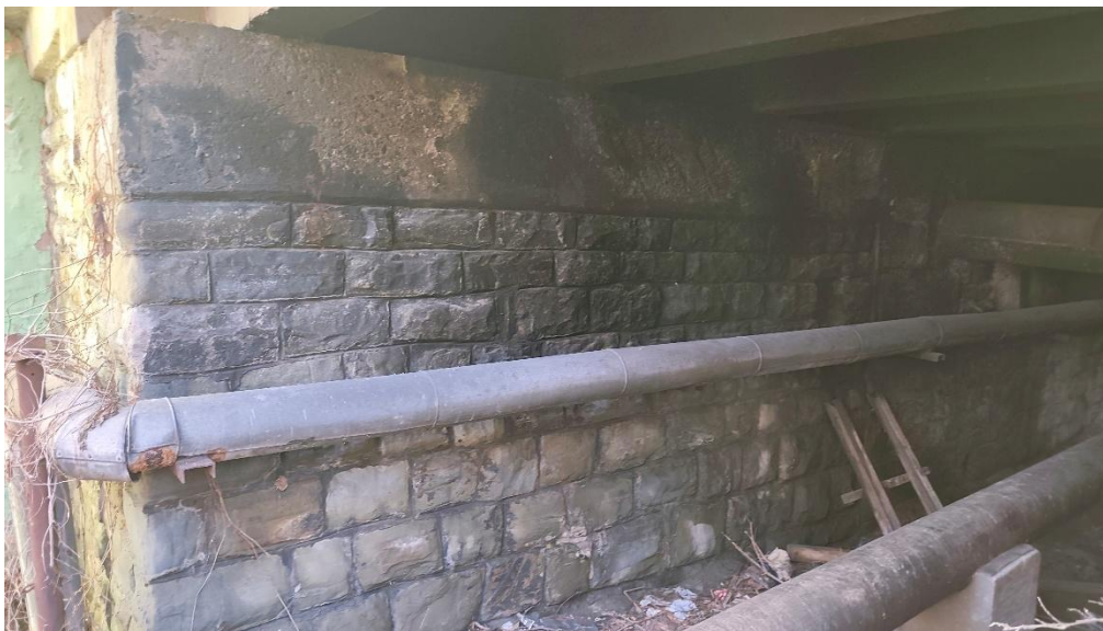
Pohled na OP1 a křídlo. Drobné síťové trhlinky ve spárování kamenného zdiva a betonovém úložném prahu po celé délce obou opěr.
