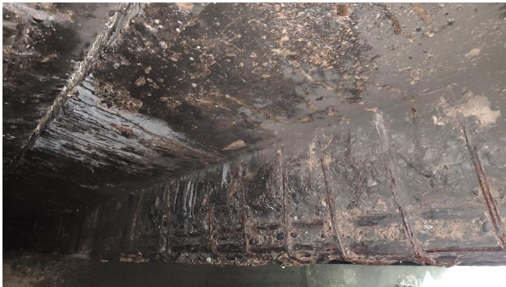
Poškozený nosník č. 10. Nosník má odpadlou krycí vrstvu výztuže, která silně koroduje s výraznými úbytky ve značném rozsahu plochy nosníku. Po požáru se stav nosníku zhoršil, zvětšil se rozsah poškození!
