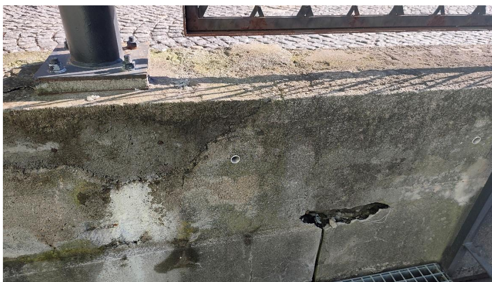
Povrch římsy je degradován. Před OP1 na pravé straně je z důvodu vstupu na ocelové schodiště část římsy ubourána. Před sloupem VO je lokálně poškozená omítka a obnažena výztuž. Pod sloupem VO je výluh.
