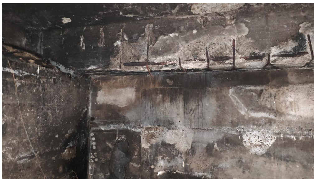
Nosník č. 14. (krajní na levé straně mostu). Nosník má odpadlou krycí vrstvu výztuže, která silně koroduje s výraznými úbytky ve značném rozsahu plochy nosníku.
