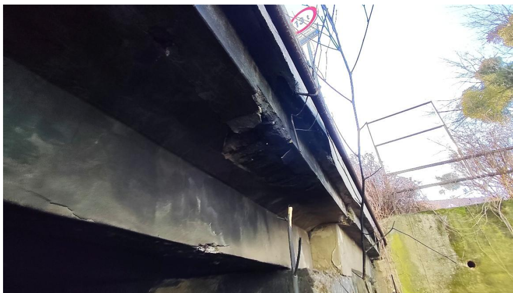
z venkovní strany má stopy po potečení, na povrchu se síťovými trhlinami s lokálně obnaženou korodující výztuží. Krycí omítka odpadává.
