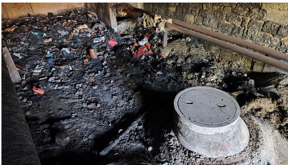
Pohled do prostoru pod mostem z pravé strany (z levé strany pod most není přístup – zazděno ). Množství inženýrských sítí – parovody, plynovod, vodovod, VO, zatrubněný potok. Nepořádek po bezdomovcích a pozůstatky po požáru v 2025/08.
