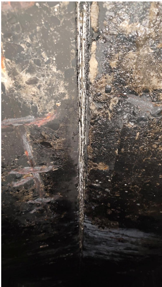
NK mezi nosníkem č. 10. a 11. je poškozena, přes podélnou dilatační spáru zatéká. Povrch NK degraduje, je zde obnažená korodující výztuž.
