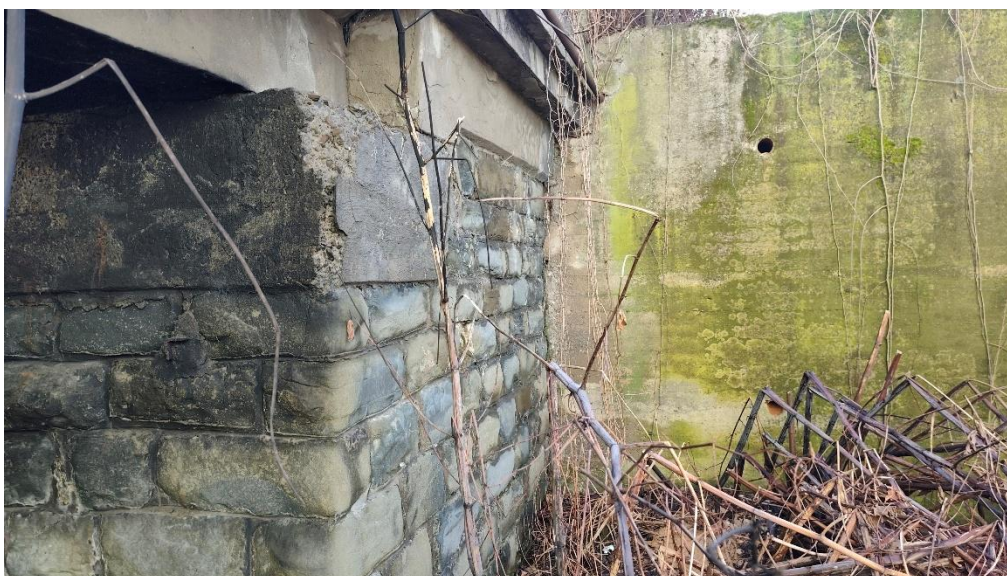
Pohled na OP2 a křídlo. Drobné síťové trhlinky ve spárování kamenného zdiva a betonovém úložném prahu po celé délce obou opěr.
