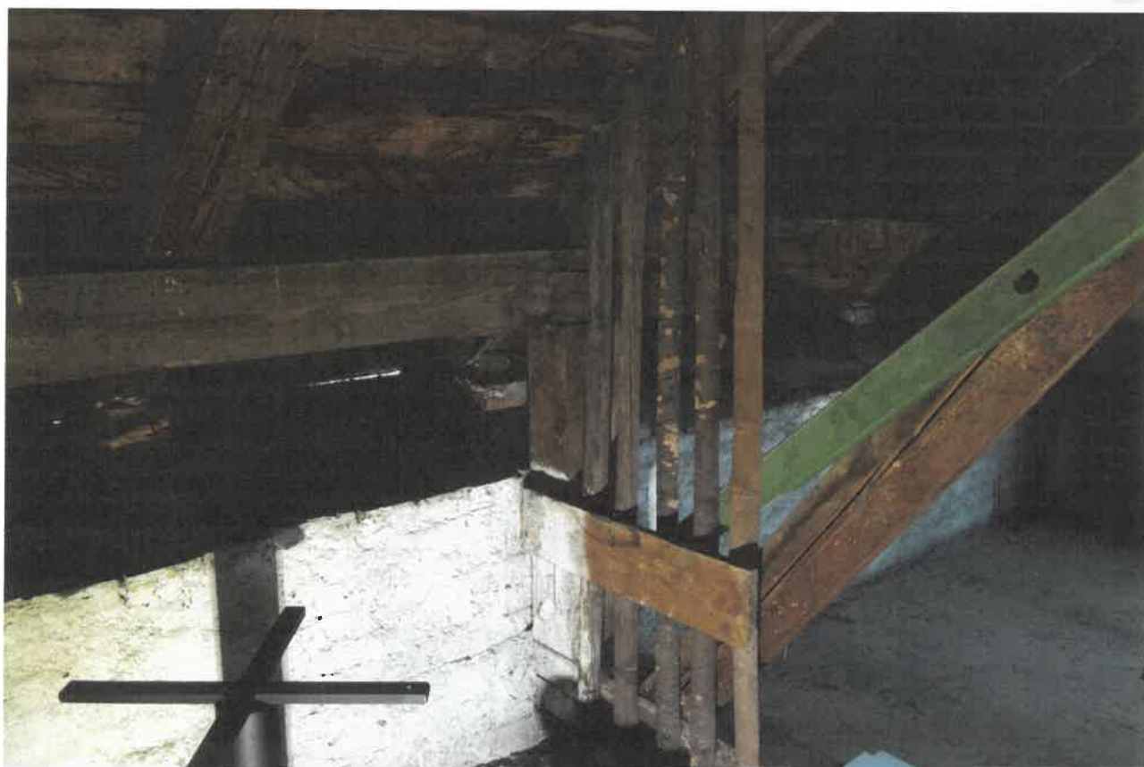
Obr.č.5: Ukázka dřevěných prvků, které by měly být odstraněny
