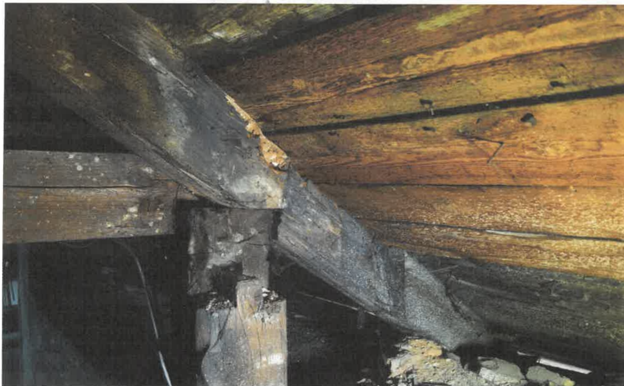
Obr.č.2: Ukázka poškození krokve dřevokaznou houbou - v současnosti již neaktivní
