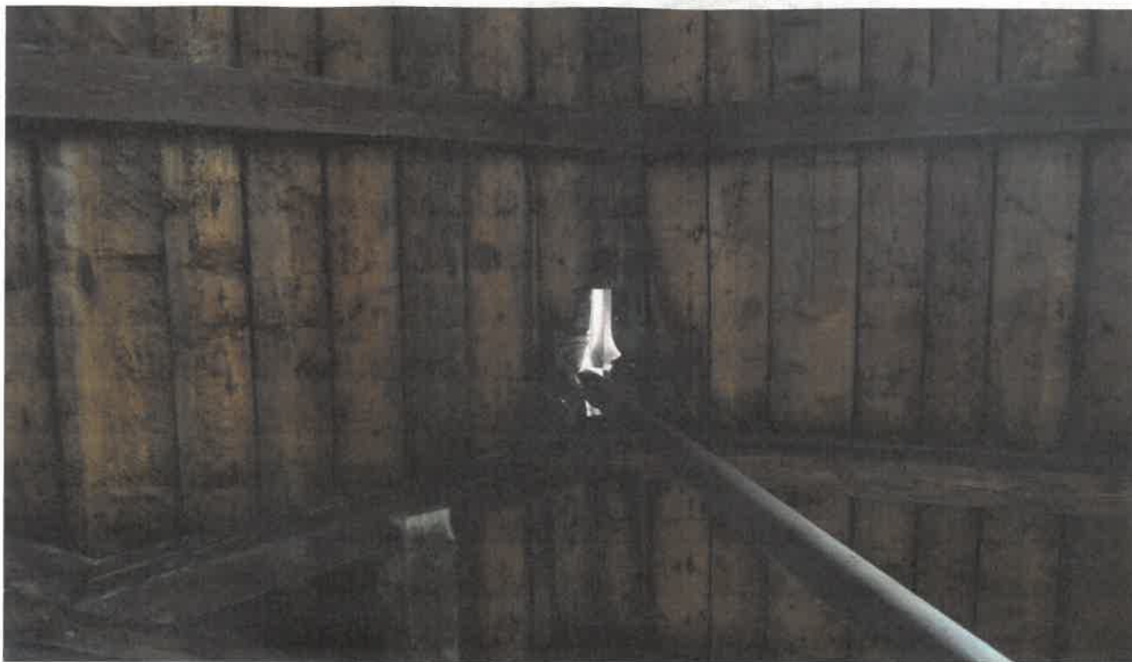
Obr.č.1: Ukázka netěsnosti střešního pláště v místě průchodu držáku antény
