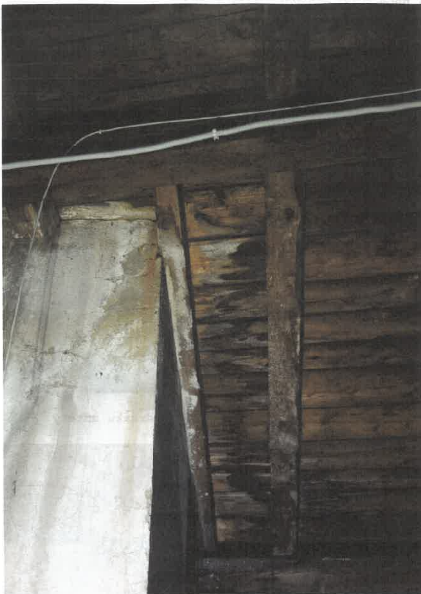
Obr.č.3: Ukázka dřevozbarvující plísně v okolí komínového tělesa
