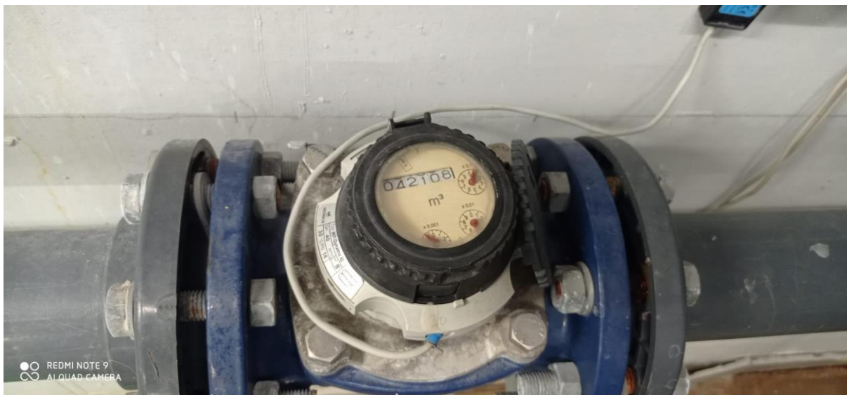
Obrázek 8 – Vodoměr dojezdový bazén
