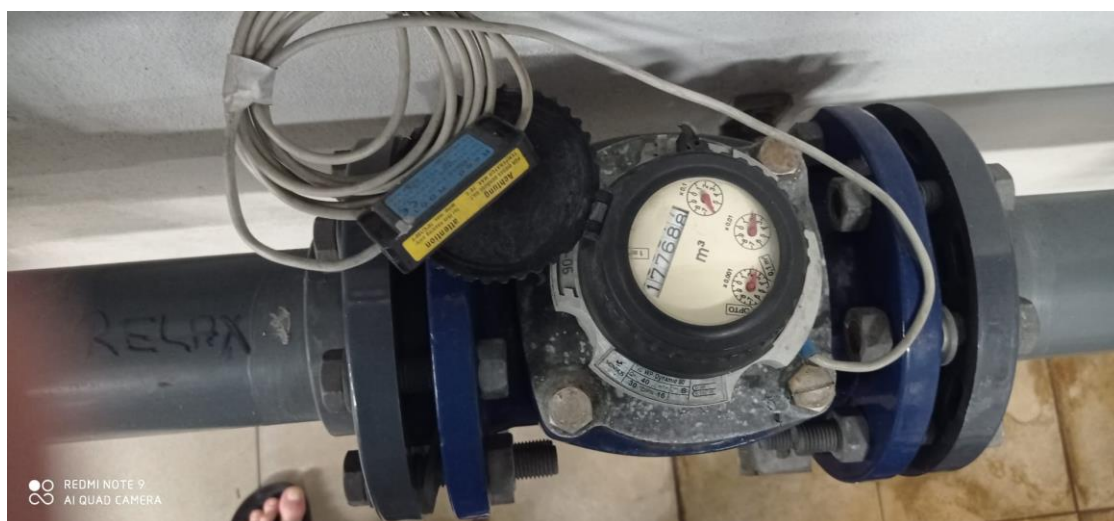
Obrázek 6 – Vodoměr rekreační bazén
