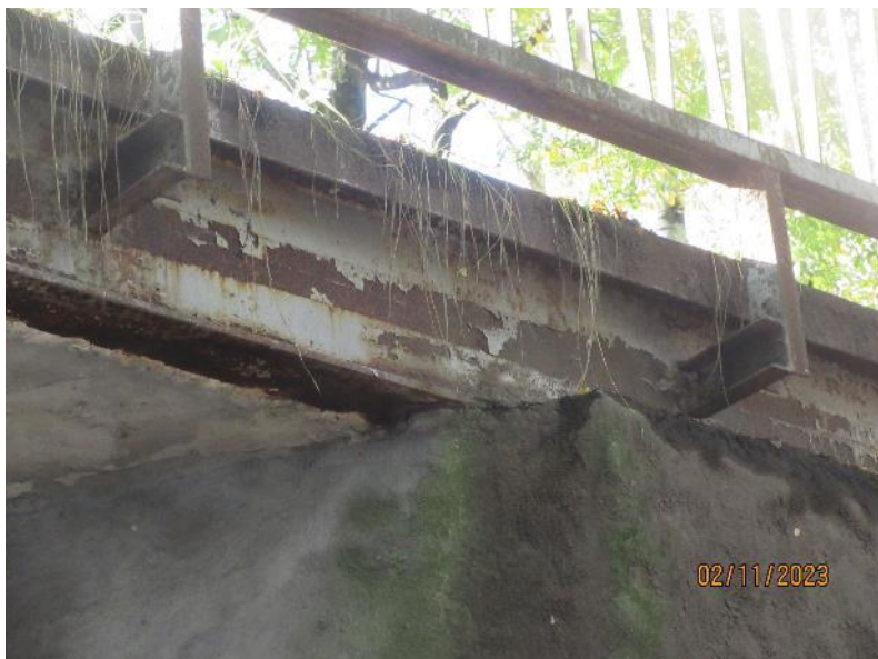
Pohled na bok NK a uchycení zábradlí. Povrchová koroze krajních ocelových nosníků.
