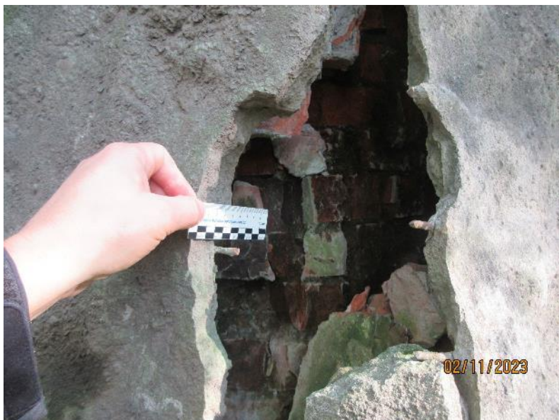
Pohled na OP2. Pod odpadlým torkretem se drojí zdivo z cihel.
