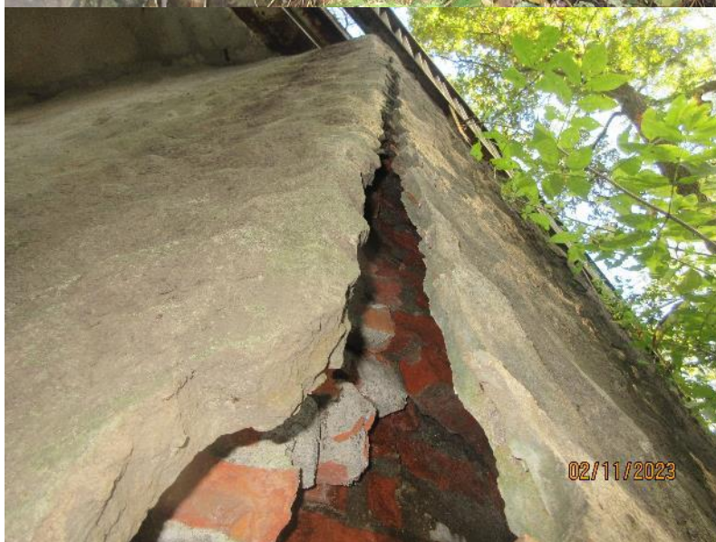
Pohled na OP2. Pod odpadlým torkretem se drolí zdivo z cihel.
