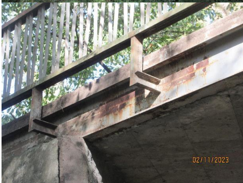
Pohled na bok NK a uchycení zábradlí. Povrchová koroze krajních ocelových nosníků.
