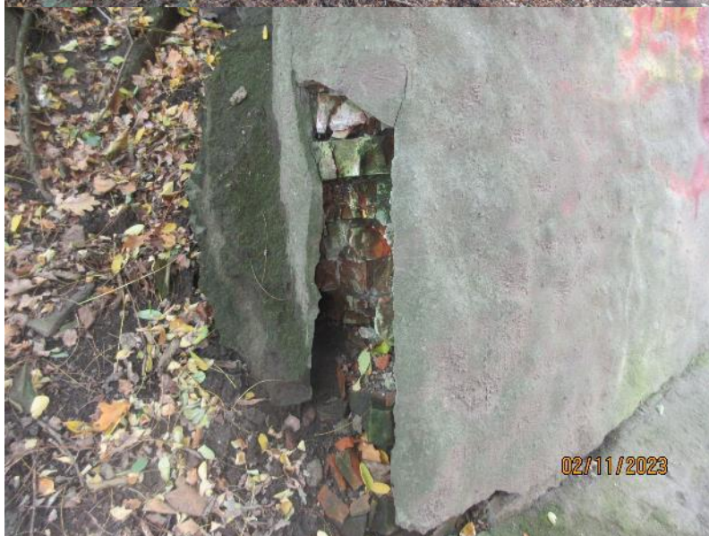
Pohled na OP2. Pod odpadlým torkretem se drolí zdivo z cihel, kari sítě nebyly na rozích při torketování řádně spojeny.
