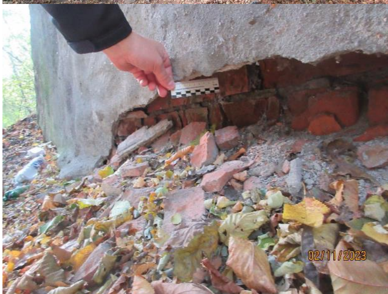
Pohled na OP1. Pod odpadlým torckretem se drojí zdivo z cihel.
