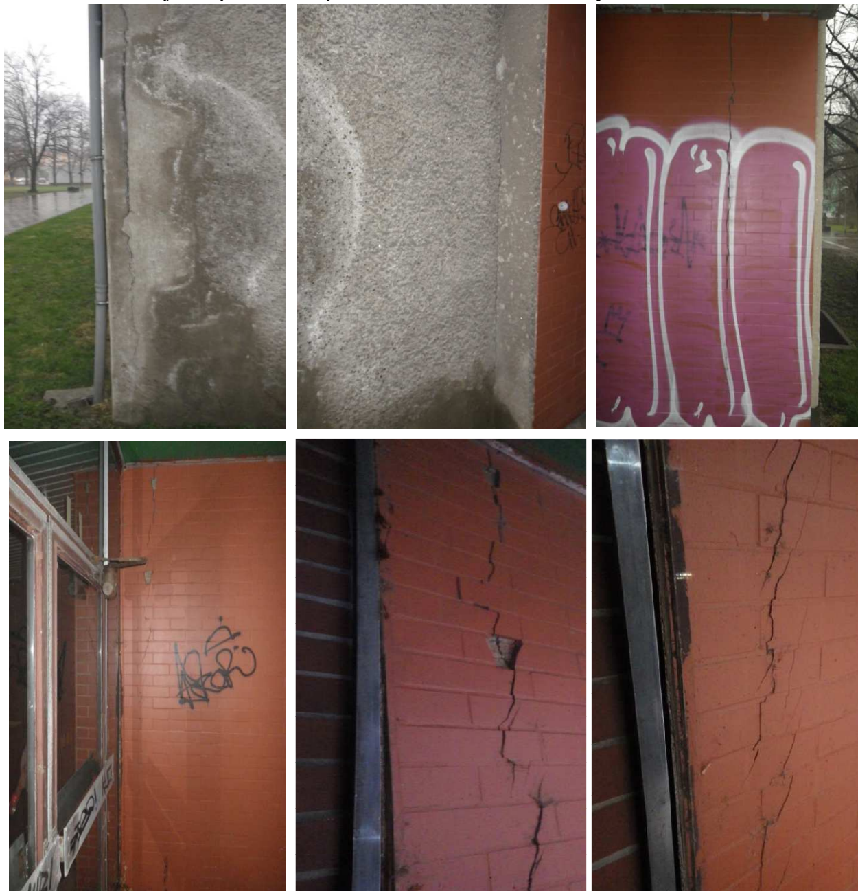
Foto č. 113-118 –jihozápadní stěna-působení vlhkosti, svislé trhliny,
