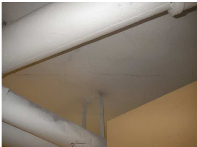
Foto č. 146 -1.PP prodejna nábytku - -šikmá trhlina ve stropní desce
