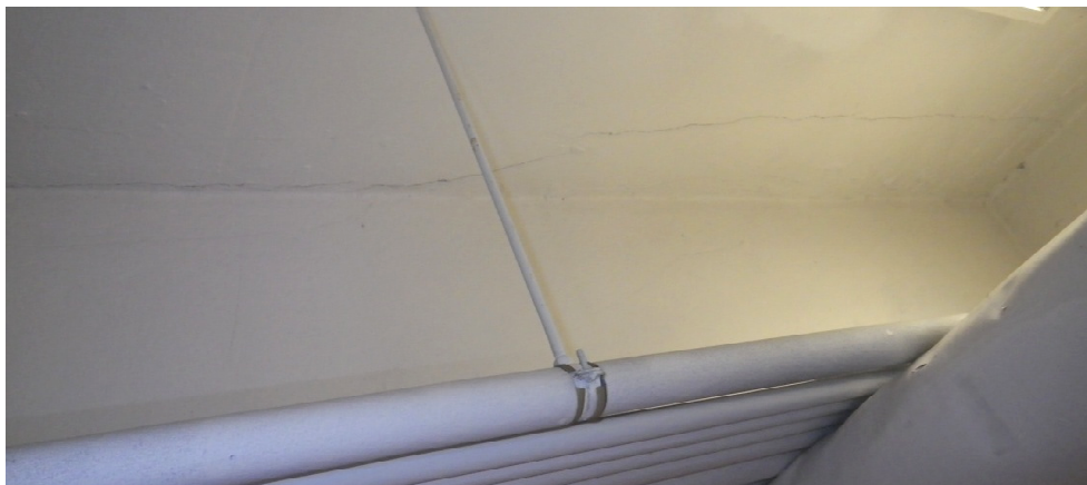
Foto č. 156 -1.PP prodejna-trhliny ve stropní desce
